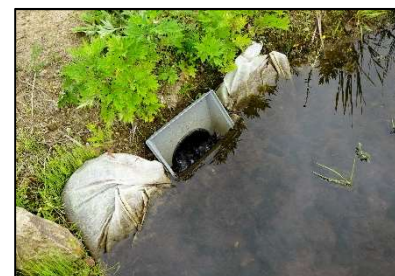
写真-3 落水口(堰板で調整)
